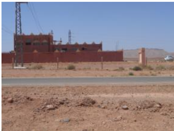
Photographie 26: Poste de livraison 22/60kv de l'ONEE-BE
