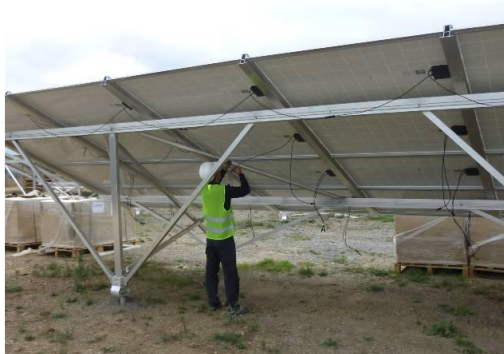
Figure 13: Câblage des panneaux
