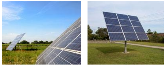
Figure 6: Panneaux photovoltaïques sur suiveur solaire
