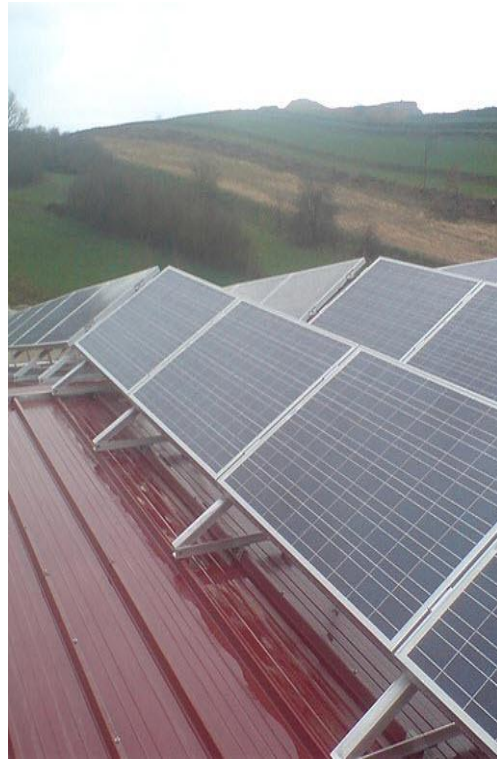
Figure 22 : Module utilisant des cellules polycristallines
