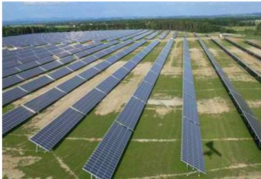
Figure 26 : panneaux photovoltaïques fixes
